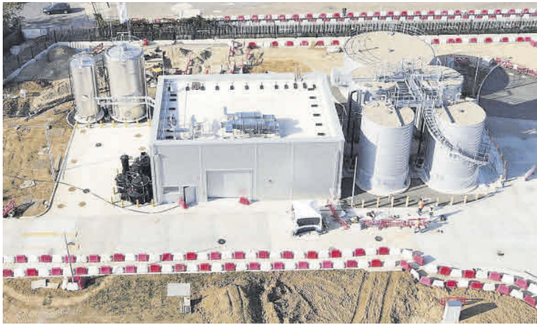
Una planta de tratamiento de agua instalada por Whitewater en un centro de datos de Italia.
